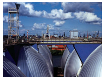
Faulgasaufbereitung zu Biomethan
