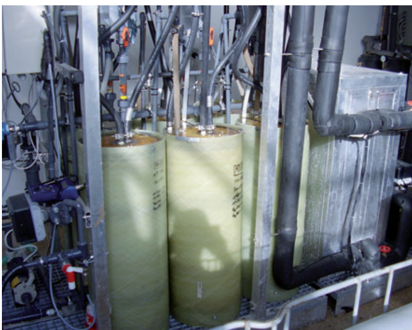
Abb. 6: Kollektorfeld und Entsalzungseinheit des Zweikreisystems auf Gran Canaria
