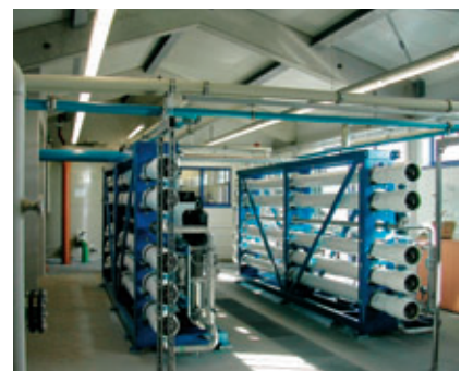
Zentrale Enthärtung von Trinkwasser
