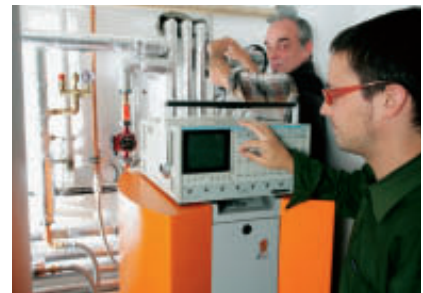
Einsatz von Mini-BHKW
