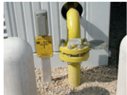
Einspeisung von Biogas
