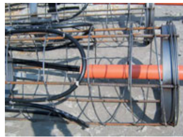
Energiepfähle: strukturelle Gebäudeelemente als Basis für eine moderne Raumklimatisierung
