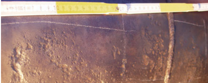
Abb. 1 Korrosion im Nahtbereich
