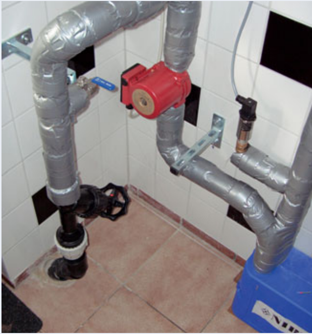
Zentrale Elemente der Pilotanlage zur Wärme- gewinnung aus dem Trinkwasserversorgungsnetz: Pumpe (rot) und Plattenwärmetauscher (blau)
