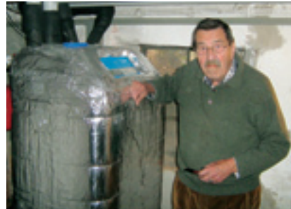
Günter Grass neben der im Keller seines Hauses installierten schallgedämmten Erdwärmepumpe
