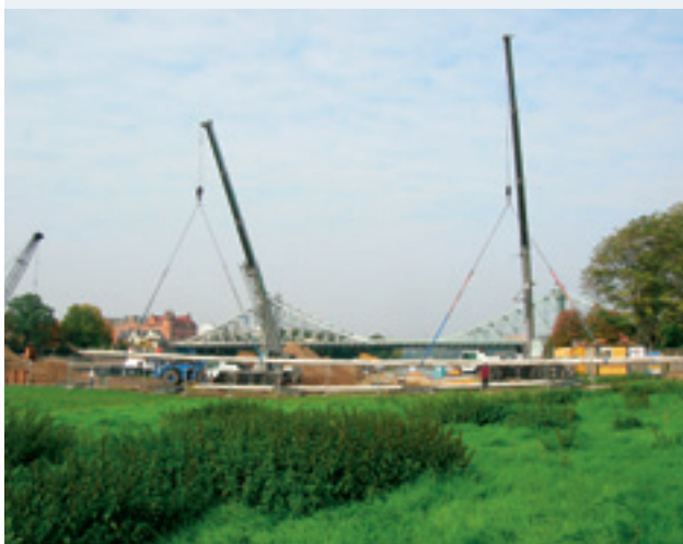
Im Vergleich zur Verlegung von 430 Metern Hochdruckgasleitung in Blasewitz und Loschwitz ungleich anspruchsvoller: der Elbdüker
