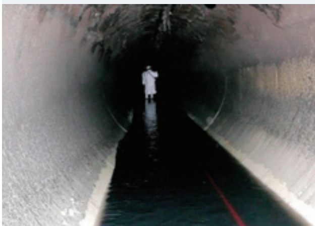
Baustellenreport: Mit dem „Zuckerbergstollen II“ in Stuttgart wurde der vermutlich längste Abwasserkanal Europas erfolgreich HD-gereinigt.
